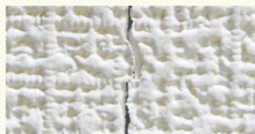
破損が見られる
